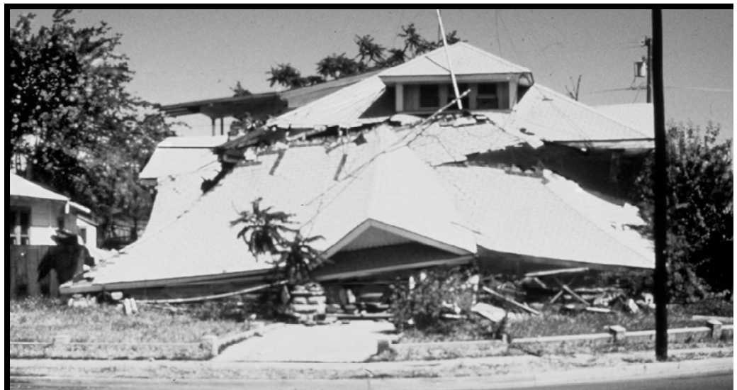
Daños por temblores adicionales
